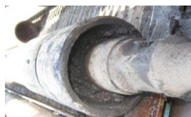
Мехпримеси в насосном оборудовании
